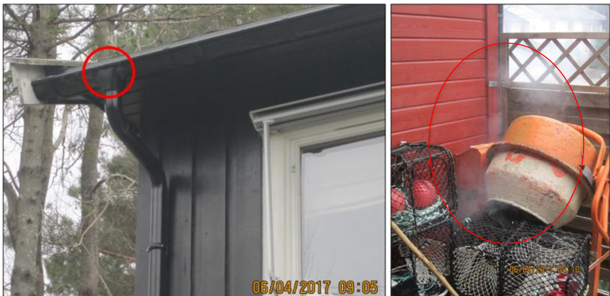
Figur 7. 19: Resultater fra røyktesting. Til venstre: feilkoblet taknedløp, til høyre: røyk stigende opp fra stakeluke uten lokk på terrasse
